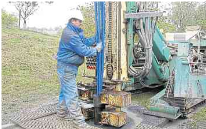
Erdreich oder Grundwasser sind als Wärmequelle für Wärmepumpen die erste Wahl. Dafür sind Bohrungen erforderlich, die bis zu 100 Meter in die Tiefe reichen können.
